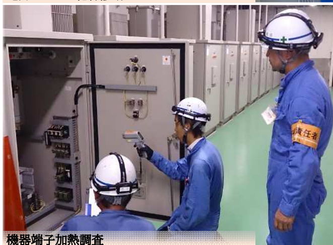
電力ケーブル絶縁診断
