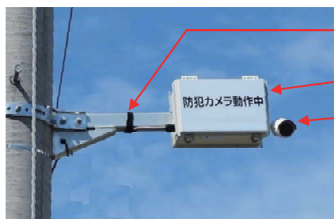
写真は電柱取り付けの一例
